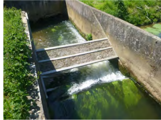
Vue de la grille à la sortie de la pisciculture, non fonctionnelle
