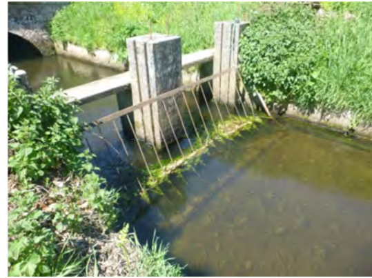
Vue de la grille à l'aval du bief (entrefer important)
