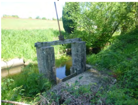
Vue de la vanne de décharge aval du bief
