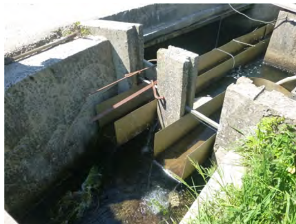
Lame d'eau insuffisante dans les goulottes
